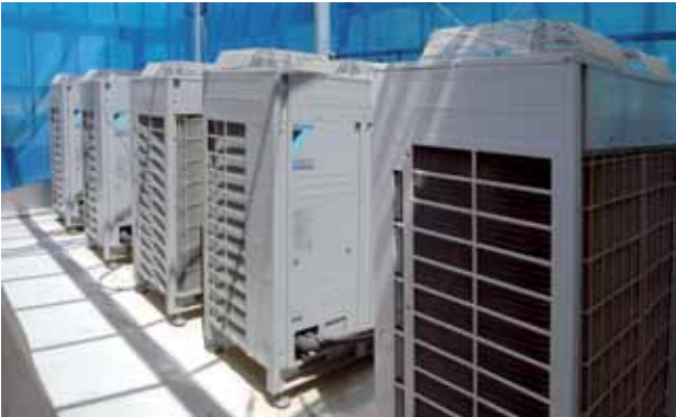
VRV con Bombas de Calor
